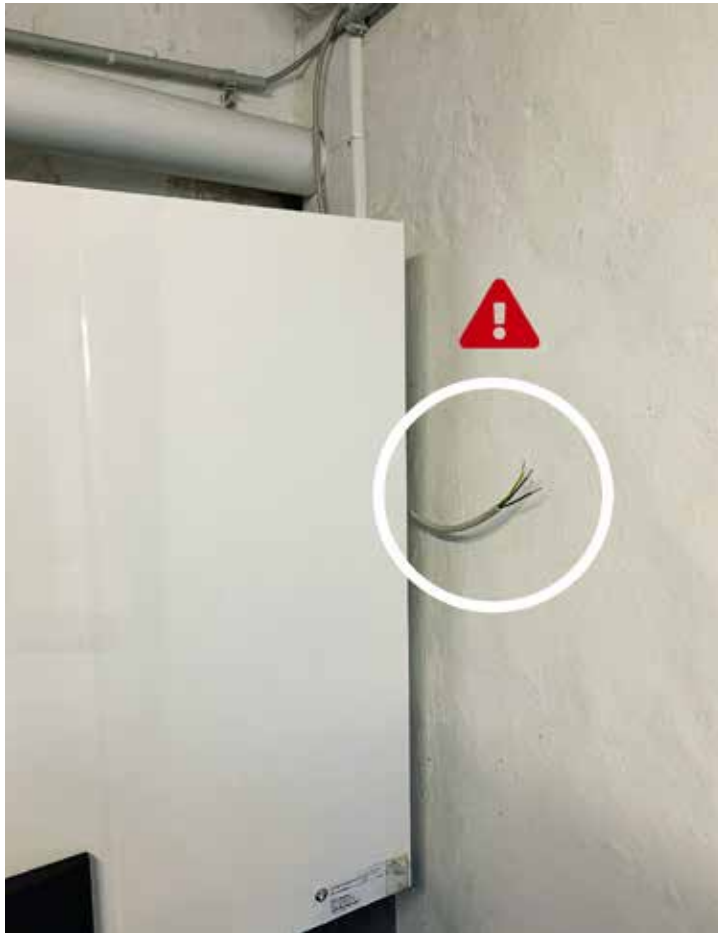
Abb. 2: Nicht isolierte Leitung in der Nähe einer Gastherme
