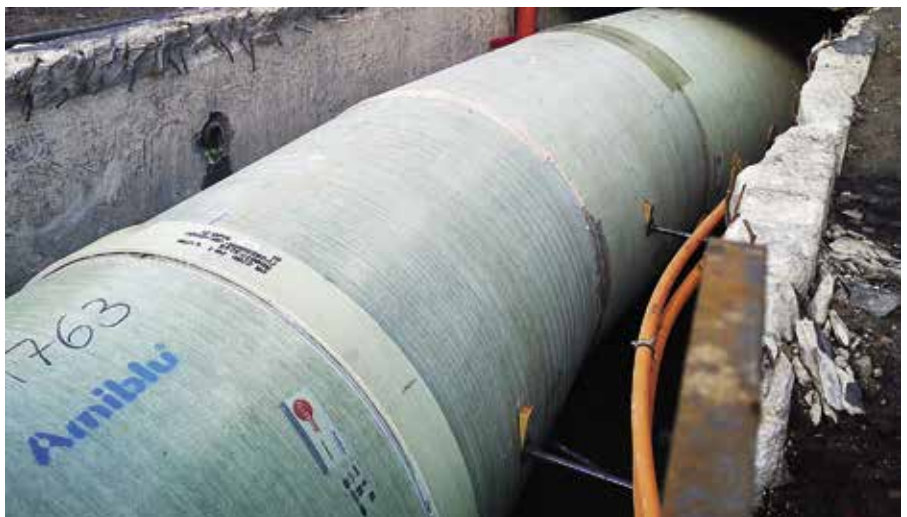
Aarsleff Rohrsanierung brachte im Görlitzer Pontekanal insgesamt 100 m GFK der Nennweite DN 2200 per Reliningverfahren ein.
