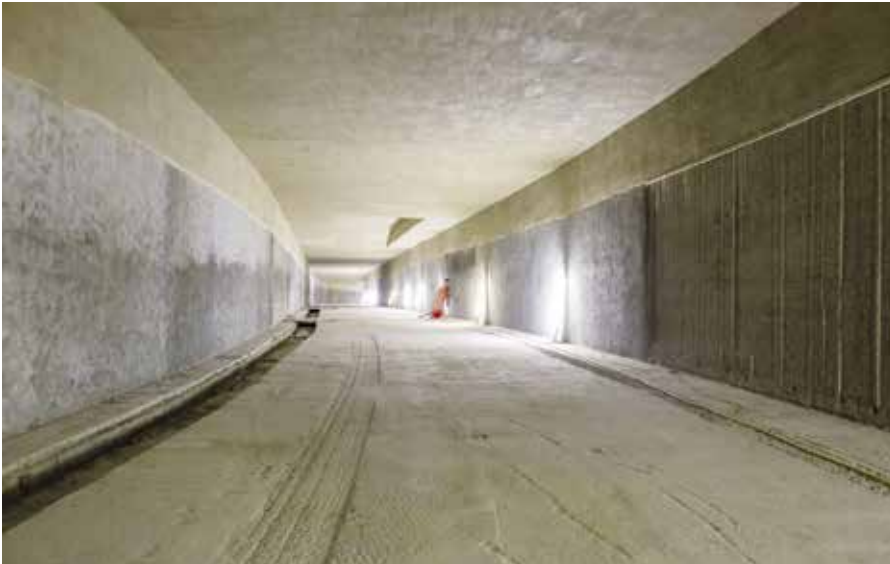
Tunneldecke sowie oberer Rand der Wand: Auf einer Länge von rund 350 m musste der Rathaus-tunnel brandschutztechnisch heutigen Anforderungen entsprechend ertüchtigt werden.
